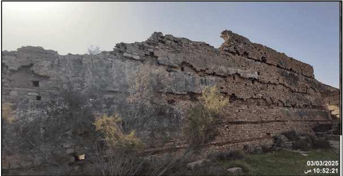
شكل (5): صورة توضح قُرب انهيار جدار كاراكالا الملاصق لمبنى البازيليكا السيفيرية من ناحية الشمال الشرقي نتيجة تأخر إجراءات الترميم. (تصوير الباحثان).
