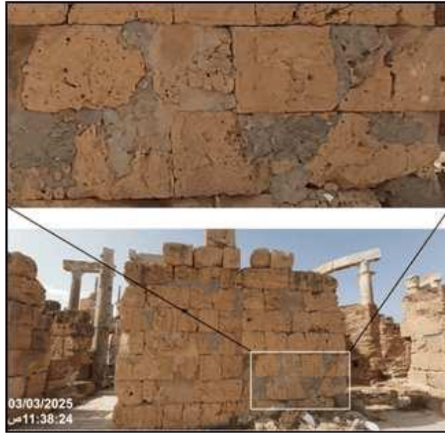
شكل (24): صورة توضح أضرار استخدام الإسمنت في ترميم جدار إحدى عُرف مسرح مدينة لبة الكبرى، مما ساهم في تكّس الأملاح داخل مسامات الحجارة الرملية وتشققها وقُرب انهيارها. (تصوير الباحثان).
