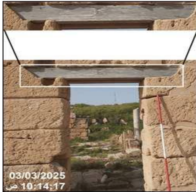
شكل (26): صورة توضح أضرار استخدام الخشب كعتبة لأحد المداخل الجنوبية للسوق البوني بمدينة لبدة الكبرى. (تصوير الباحثان).
