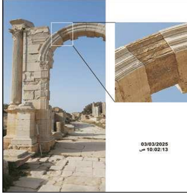
شكل (23): صورة توضح أضرار استخدام مادة الإسمنت في ترميم عقد قوس الإمبراطور تراجان، مما ساهم في تكّس الأملاح على القطعة المرّمّة وقُرب انهيارها. (تصوير الباحثان).
