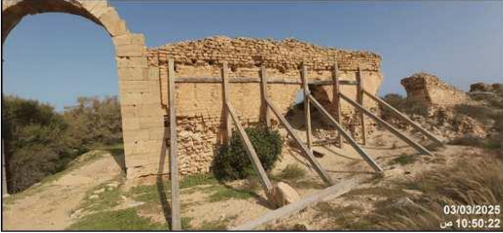
شكل (27): صورة توضح أضرار استخدام الخشب في دعم الجدار الشمالي الشرقي المُلاصق للبازيليكا. (تصوير الباحثان).
