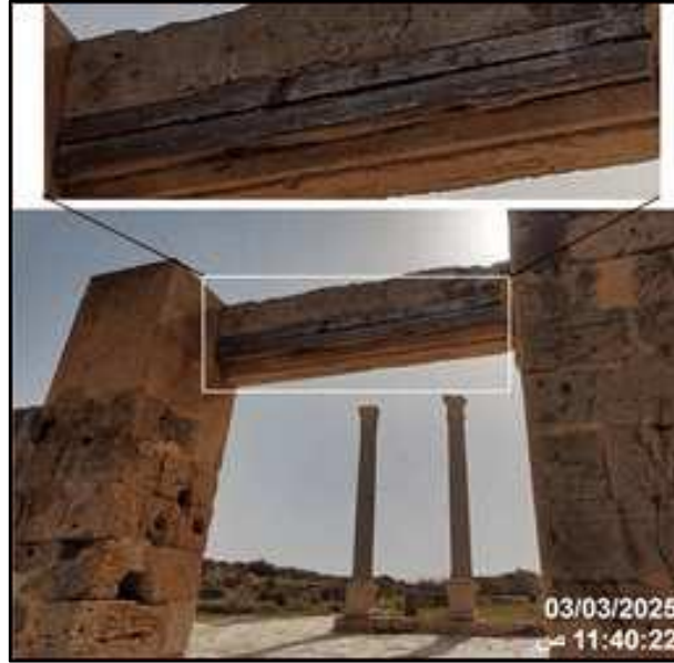
شكل (25): صورة توضح أضرار استخدام الخشب كعتبة لمدخل إحدى عُرف مسرح لبدة الكبرى. (تصوير الباحثان).
