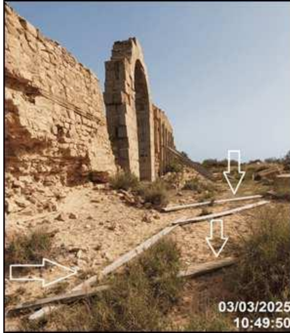
شكل (28): صورة توضح سقوط قطع ألواح الخشب الداعمة للجدار الشمالي الشرقي المُلاصق للبازيليكا. (تصوير الباحثان).
