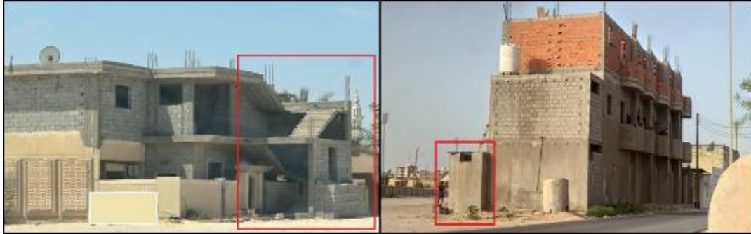
صورة (5) التعدي على المساحات الفضاء وإنتشار نفايات البناء وعدم وضع سواتر على الأبنية
