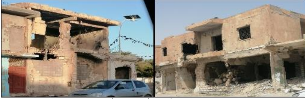
صورة (11) المباني المدمرة من الحرب
